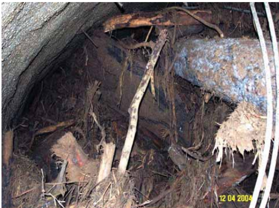
Organické znečištění tunelu (foto EDCOP)
