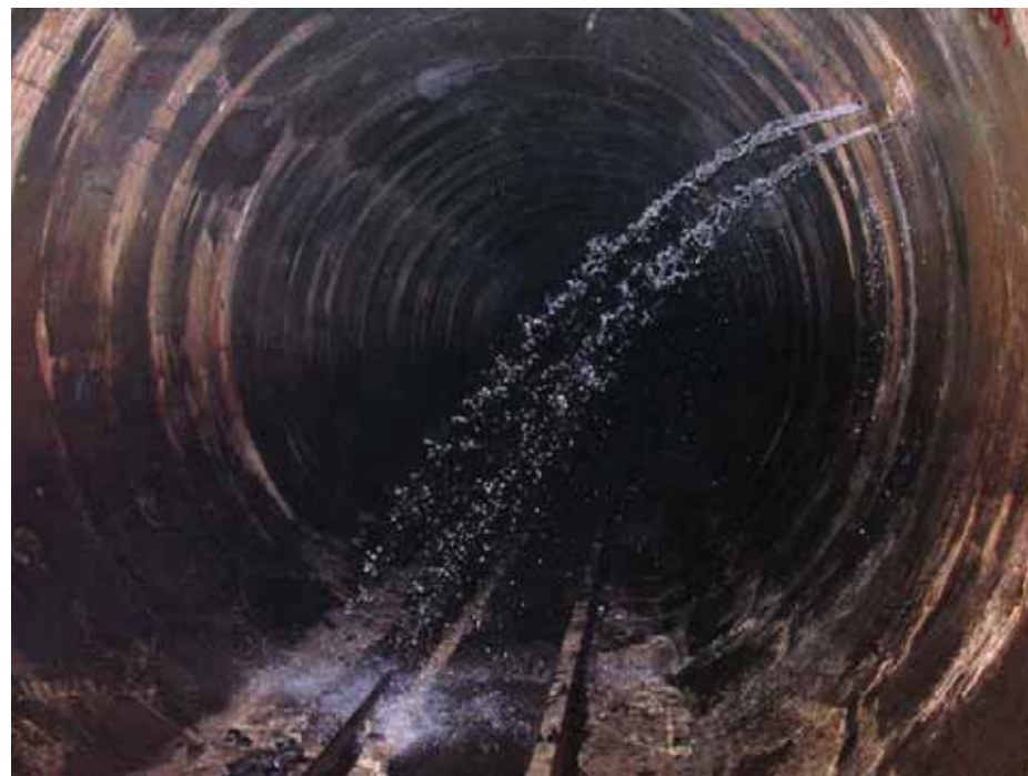
Mohutný přítok do tunelu
