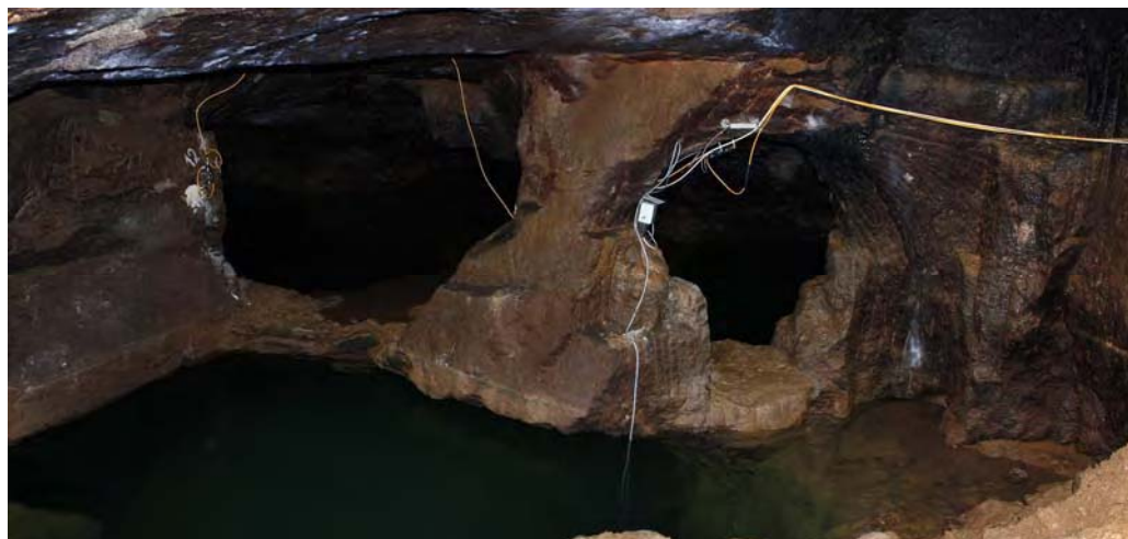
Obr. 3 Porušený klenbový pilíř – můstek
