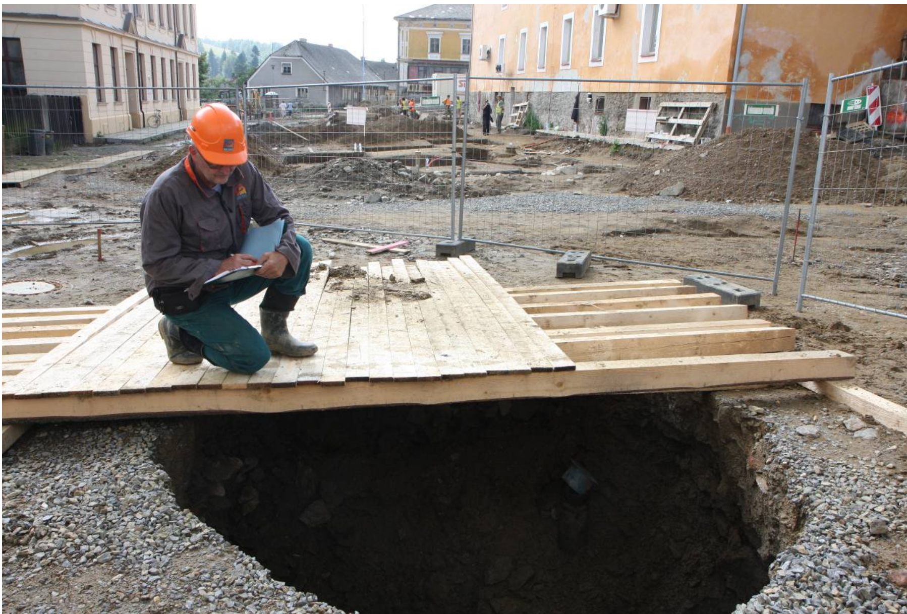
Obr. 4 Propad povrchu po průtrži mračen, 2009
