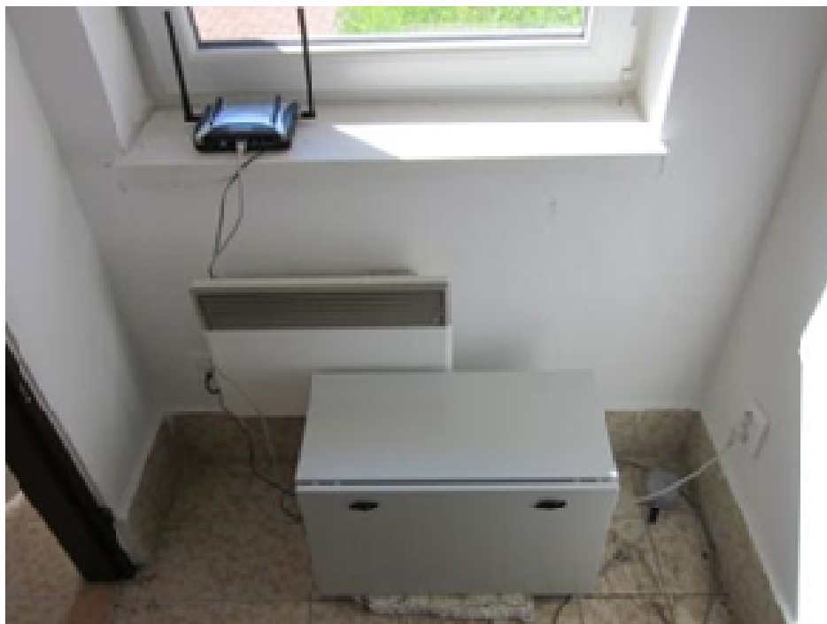
Obr. 3 Snímač a router na povrchové stanici
