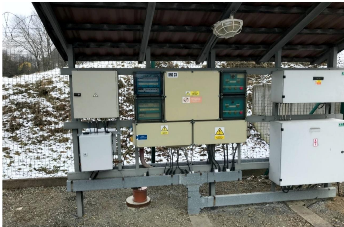
Obr. 10 Instalace solitérní seismické stanice ve venkovním rozvaděči monitorovacího vrtu VT23 na podzemním zásobníku plynu ve Štramberku
