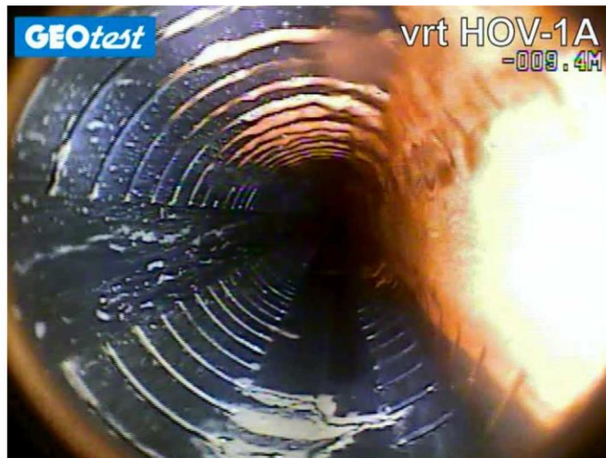
Obr. 9 Zanášení perforace pažnic jílovitým materiálem
