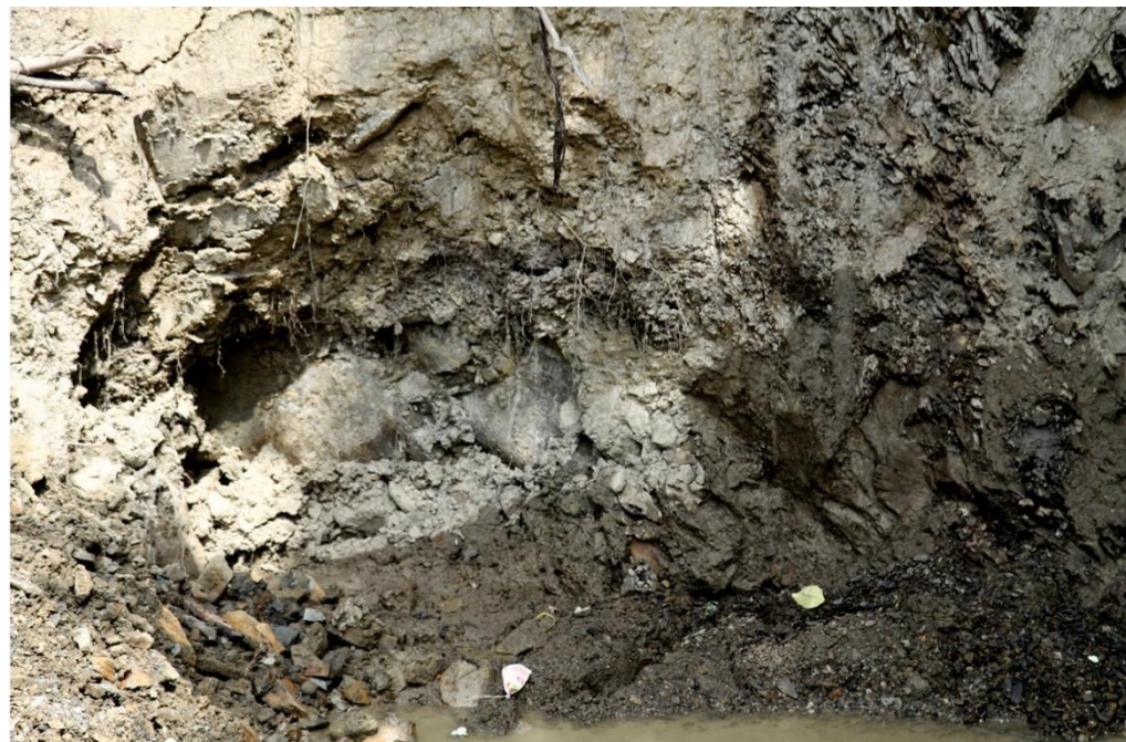
Obr. 4 Materiál v čele sesuvu
