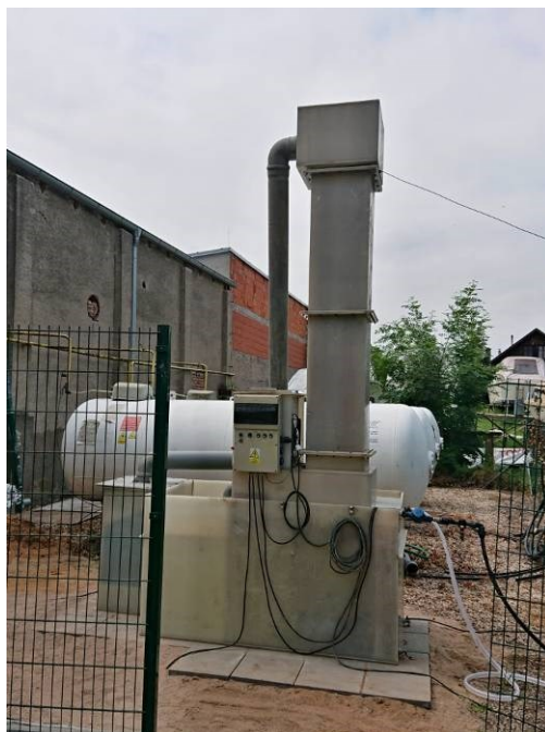
Stripovací kolona od firmy Neogene, s.r.o.
